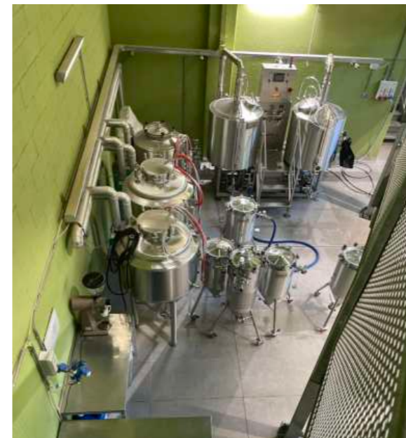
Figura 54. Filtrazione, Fonte: foto dell'autore
