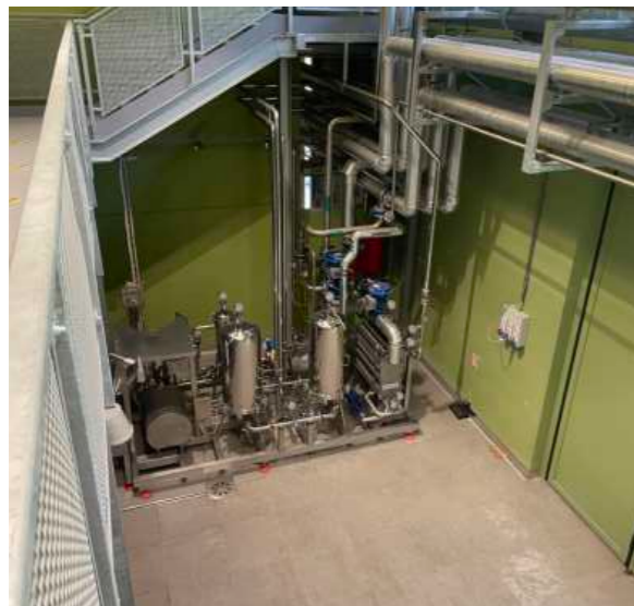
Figura 57. Impianto di raffreddamento, Fonte: foto dell'autore
